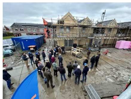
Figuur 1-1: TLC woningen in aanbouw Wierden en Borgen (bron: Wierden en Borgen)
